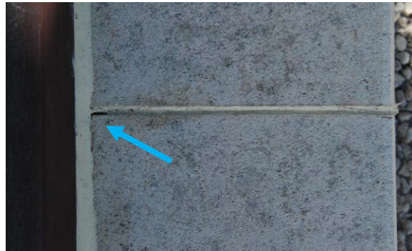
Openstaande voeg (na herstelling!)
