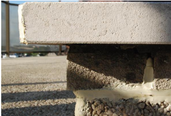
Loskomend metselwerk (vorstschade)
